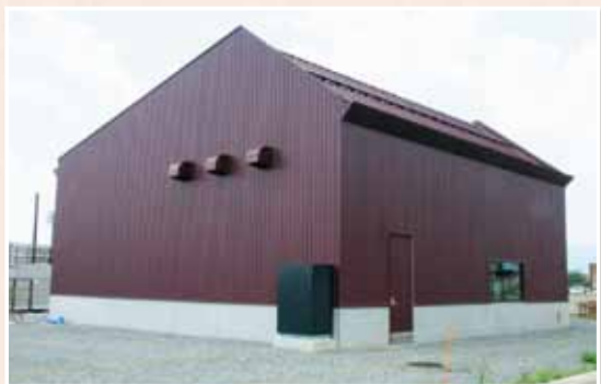
遠隔監視による無人での運営も特徴的なエネルギーステーション
