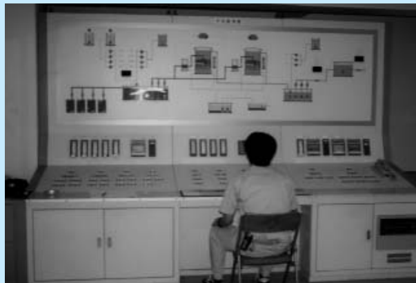
施設制御盤を監視する職員
