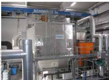
ドイツで使用されている チップボイラー
