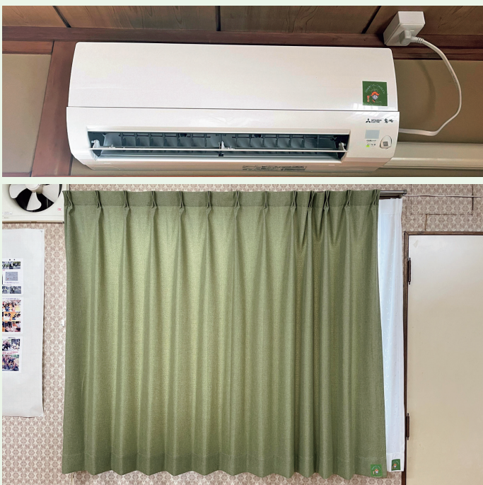
コミュニティ助成で整備されたエアコンとカーテン(上町自治公民館)
